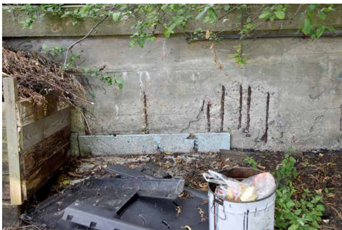
Betonabplatzungen und freiliegende Bewehrung
