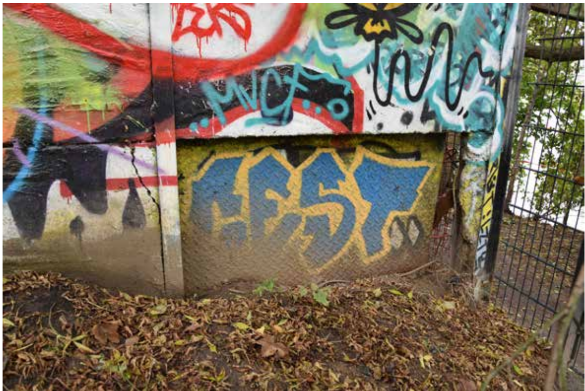
Loch - fehlende Betonplatte
