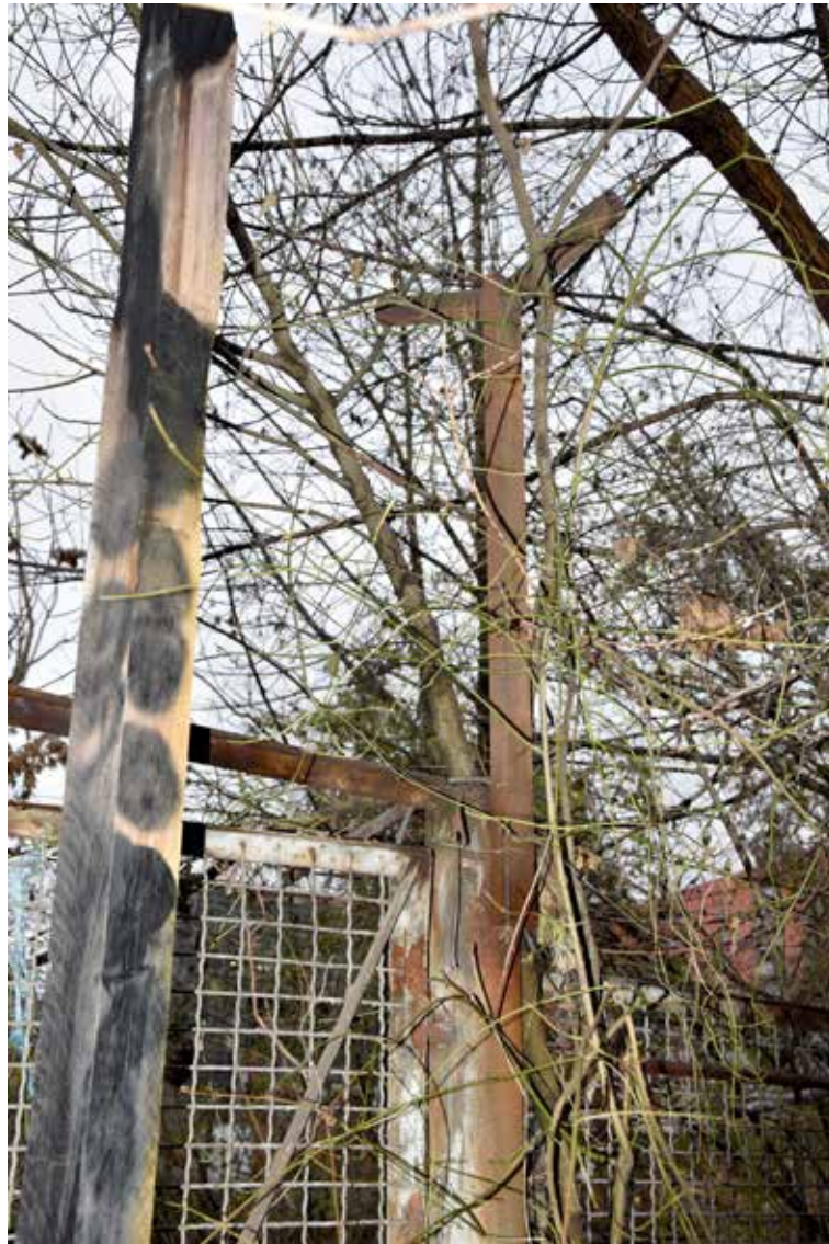
Grenzzaun - Lampenhalterung 2 (am Tor) fehlende Lampe
