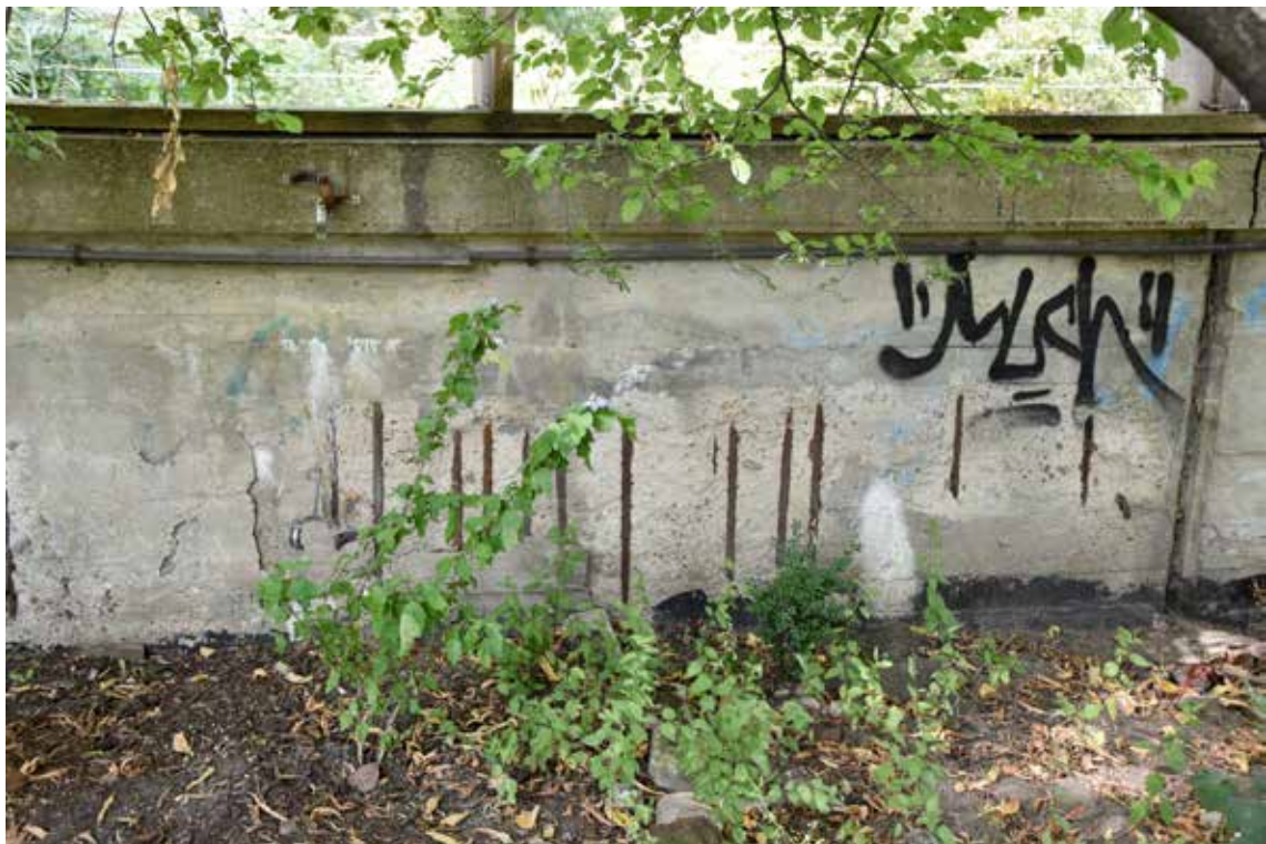
Betonabplatzungen und freiliegende Bewehrung
