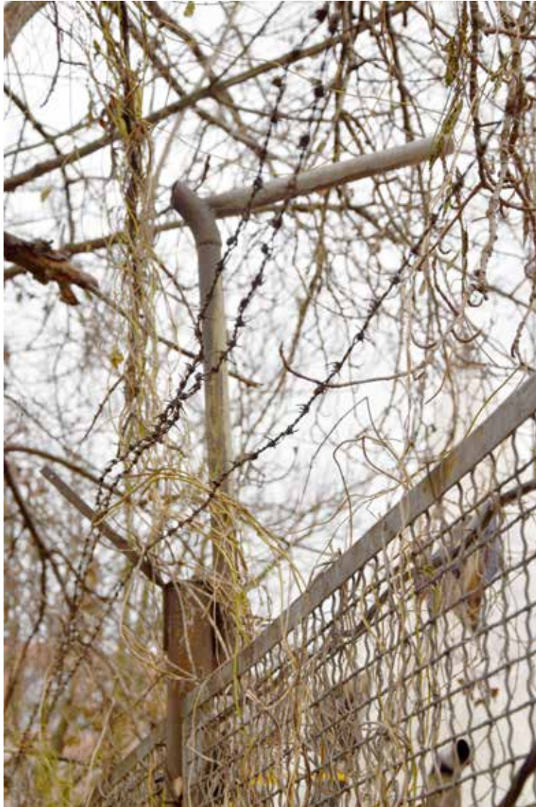
Grenzzaun - Lampenhalterung 1 fehlende Lampe
